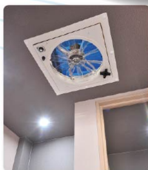
照明・換気扇
