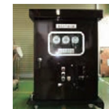
ゲート操作盤
