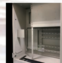
エレベータ用制御盤(内部)
