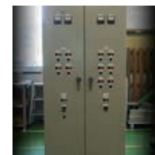
工場設備 (動力制御盤)
