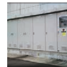
受変電設備盤
