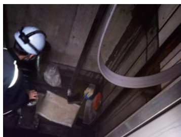
エレベーターピットの漏水
