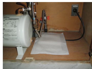
配管の水漏れ
