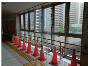
駅構内の雨漏り
