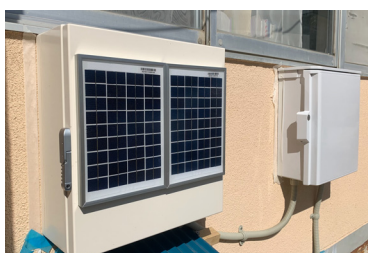
校舎壁面に設置した検知装置本体とソーラーUPS
