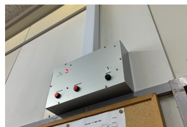
室内に設けられたコントロールBOX
