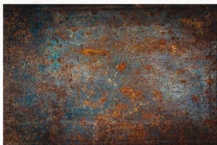
酸化被膜(錆・スケール)が生じた鉄板や配管
