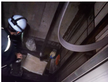
エレベーターピットの漏水
