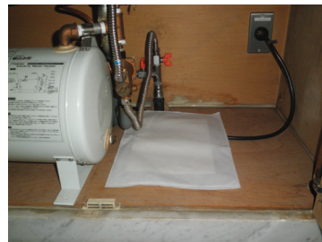
配管の水漏れ
