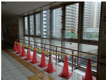
駅構内の雨漏り
