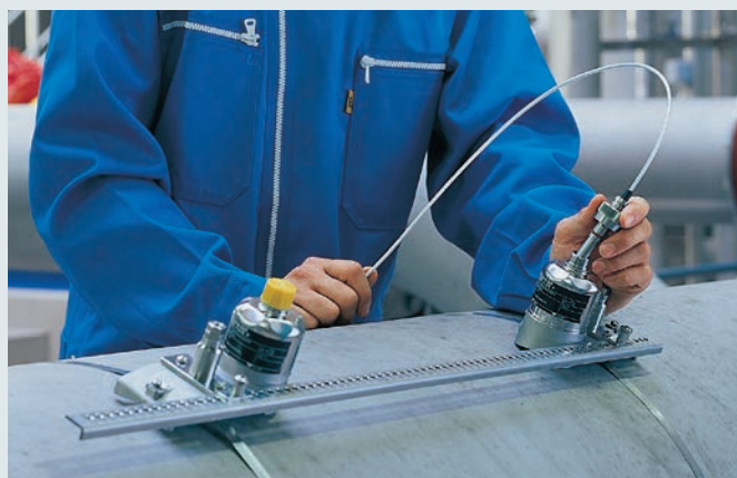
既設流量計の検証
