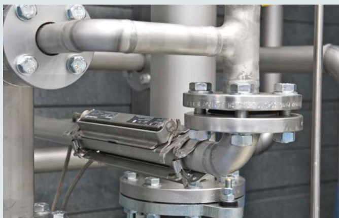
故障した流量計の代替え測定
