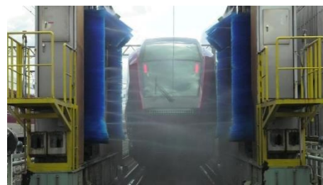
車体洗浄装置
