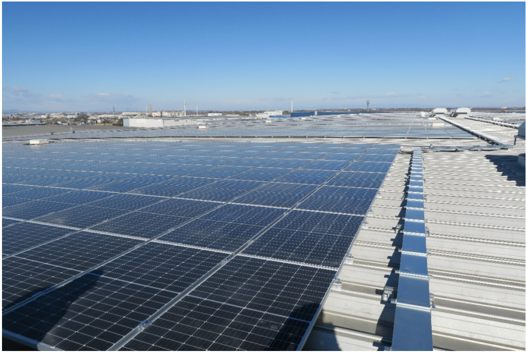
「ベネックス川越ソーラーポート」屋上設置太陽光パネル
