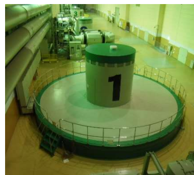
（発電機上部写真）
