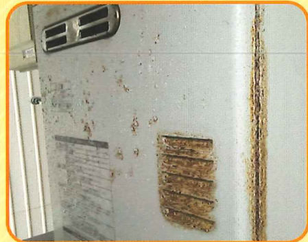
外装が錆で損傷
