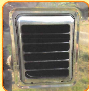
排気口がススで汚れている
