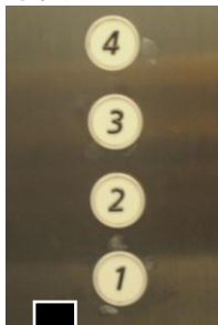
エレベーターの ボタン
