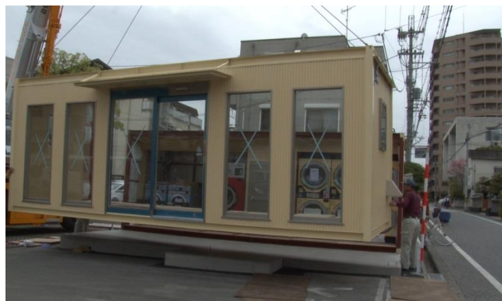
コインランドリー機器も設置したままクレーンで吊って移転。
